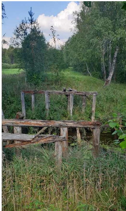
11.attēls. Sabrukušais tilts pār Līksnas upi.
